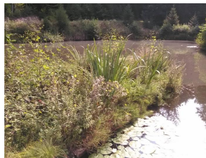
1-3-1 MVN pohled na zarostlou hranu bezpečnostního přelivu nádrže, Pod Schindlerem II
