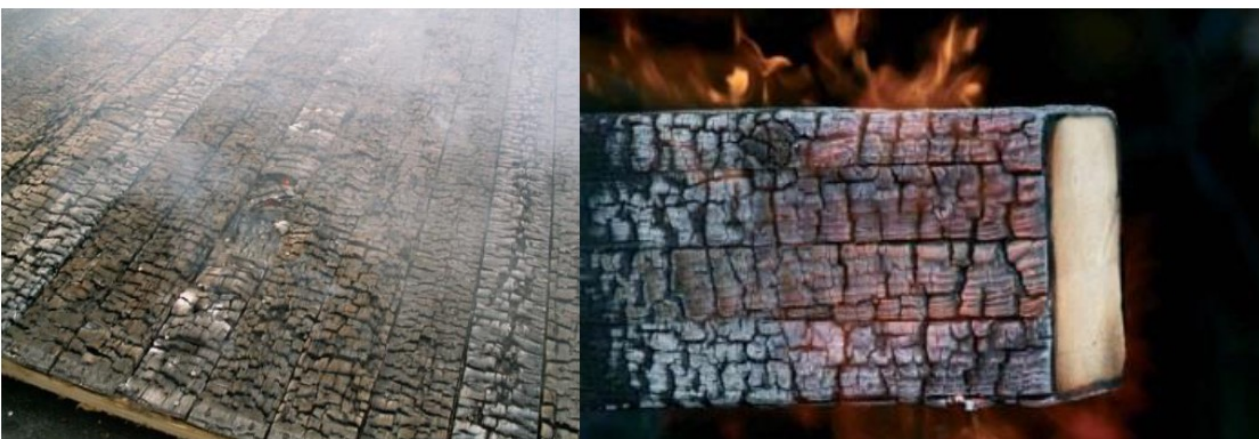
Obr. 4 Masivní dřevěné prvky po požáru (stěna z CLT a dřevěný nosník)
